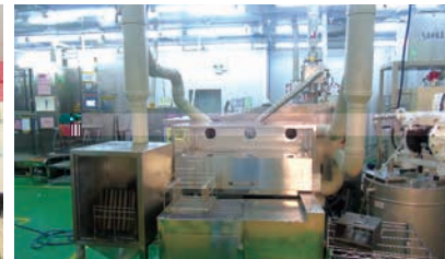
加裝排風系統後之雷岡清洗機（金橋廠）
